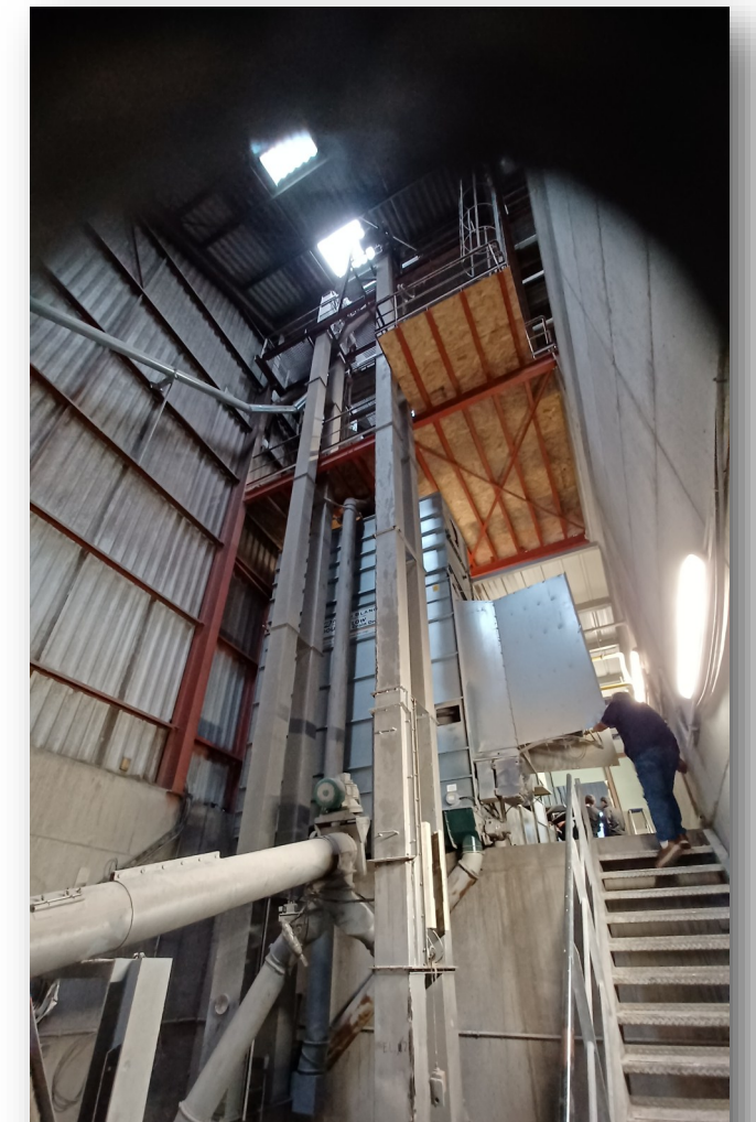
Installation de stockage chez Yves Rannou à Lennon. Séchoir Alvan Blanch horizontal
