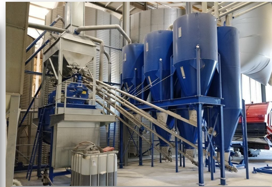
6 cellules minérales. 1 trémie pour le pesage des matières à broyer équipée d'un cyclo-filtre qui communique avec les cellules à minéraux, la mélangeuse et des cellules aliments finis.
